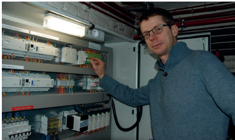
Le responsable Energie de la Ville Tanguy Boucquey vérifie ici le compteur de l'hôtel de ville d'Ottignies. En page 5, les panneaux solaires du centre sportif des Coquerées.
